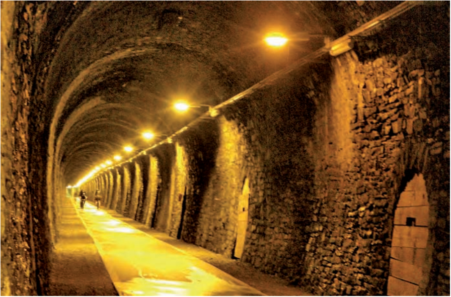
Abb. 15: Beleuchtung im Tunnel Kückelheim 5.9.2010.
