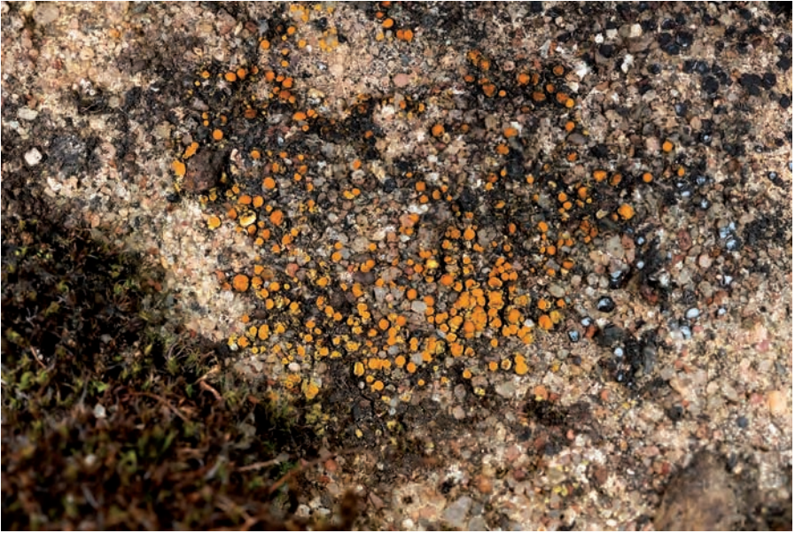
Abb. 9: Beton mit den kalkliebenden Arten Caloplaca oasis (orange) und Sarcogyne regularis (weiß bereift)
