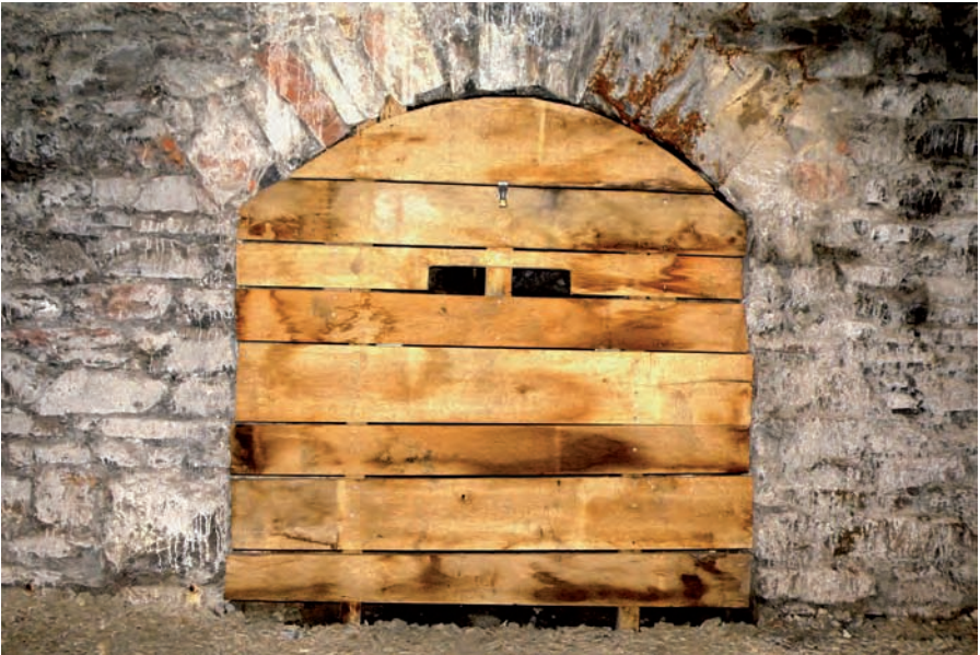
Abb. 16: Eichenholz-Verkleidung der Fluchtnischen mit Einflugöffnungen für Fledermäuse und Kontrollklappe im Tunnel Kückelheim 5.9.2010.
