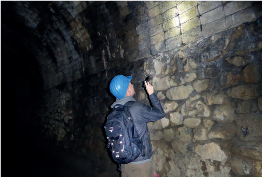
Abb. 7: Bei der Winterkontrolle muss entlang der Tunnelwände und -decke ein ca. 13km langes Netz aus Mauerspaltan abgeleuchtet werden. (Foto: T. Kordges)
